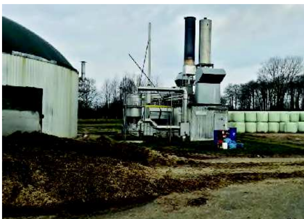
Abb. 15 Blockkraftheizwerk der vorhandenen Biogasanlage
