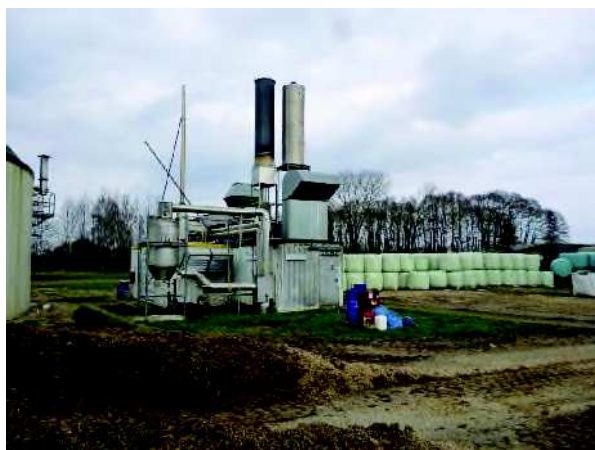
Abb. 22 Vorhandenes Blockheizkraftwerk (BHKW)
